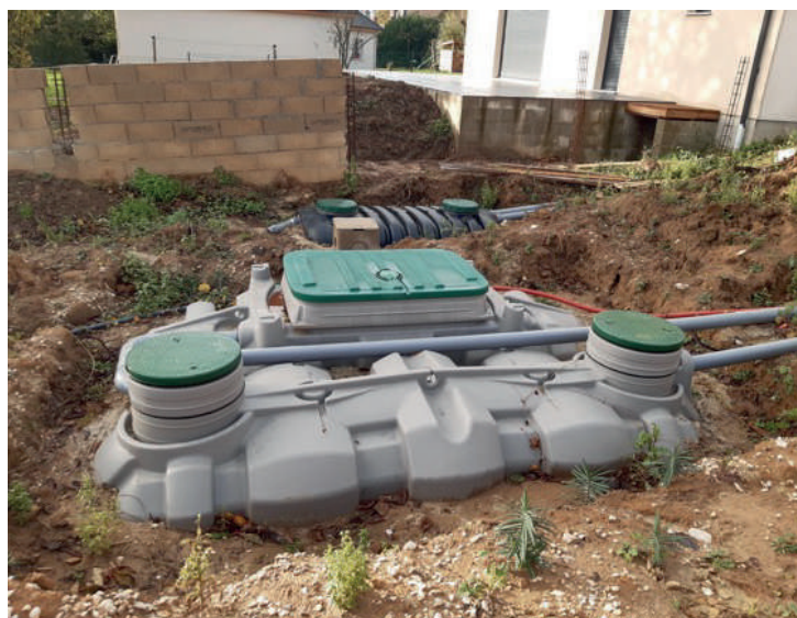
Assainissement non collectif composé d'un filtre compact
