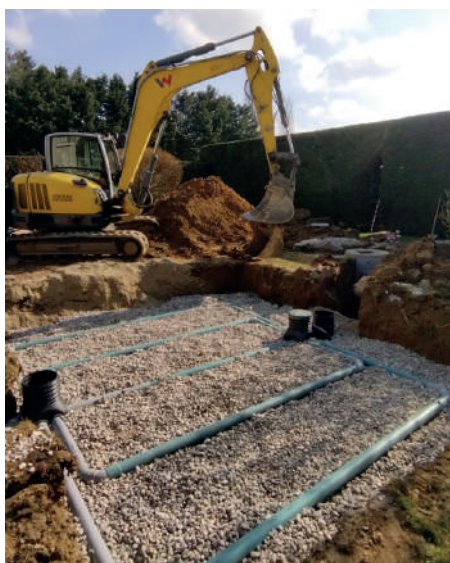
Assainissement non collectif composé d'un lit d'épandage
